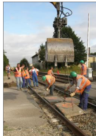
■ Des rails à niveau, nécessaires pour la sécurité.
